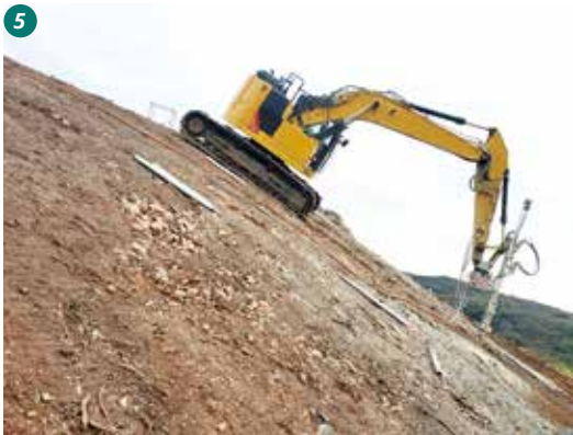
ENERGY INDUSTRY / CALIFORNIA INDUSTRIE DE L'ÉNERGIE / CALIFORNIE Anchoring a solar park under the steepest conditions Ancrage d'un parc solaire dans les conditions les plus abruptes
