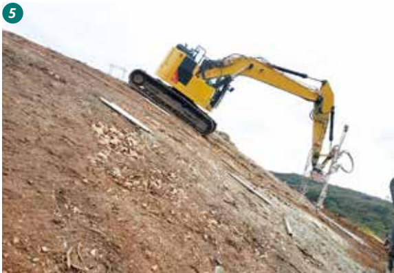
INDUSTRIA ENERGÉTICA / CALIFORNIA SETOR ENERGÉTICO / CALIFÓRNIA Anclaje de un parque solar en las condiciones más pronunciadas Instalação de complexo solar em terrenos de inclinação extrema
